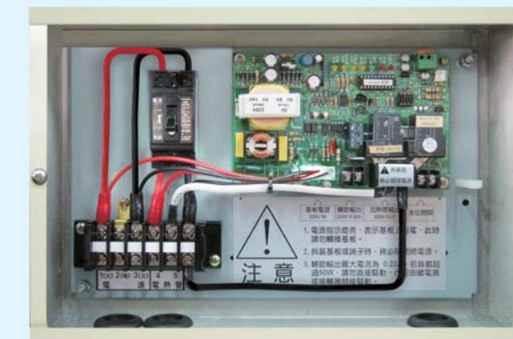
微電腦全自動電熱輔助器主控制箱(室外)
