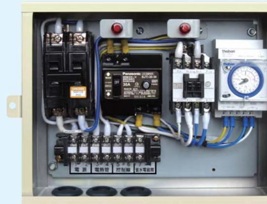
電機式電熱輔助器主控制箱(室外)
